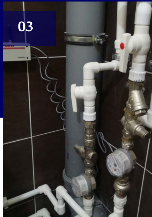
Подключение водосчетчиков с использованием беспроводной системы на частоте 434 МГц
