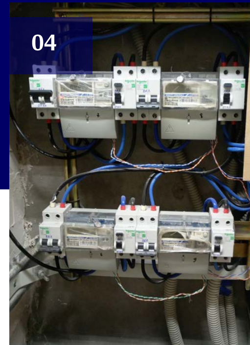
Подключение электросчетчиков по проводному интерфейсу RS-485
